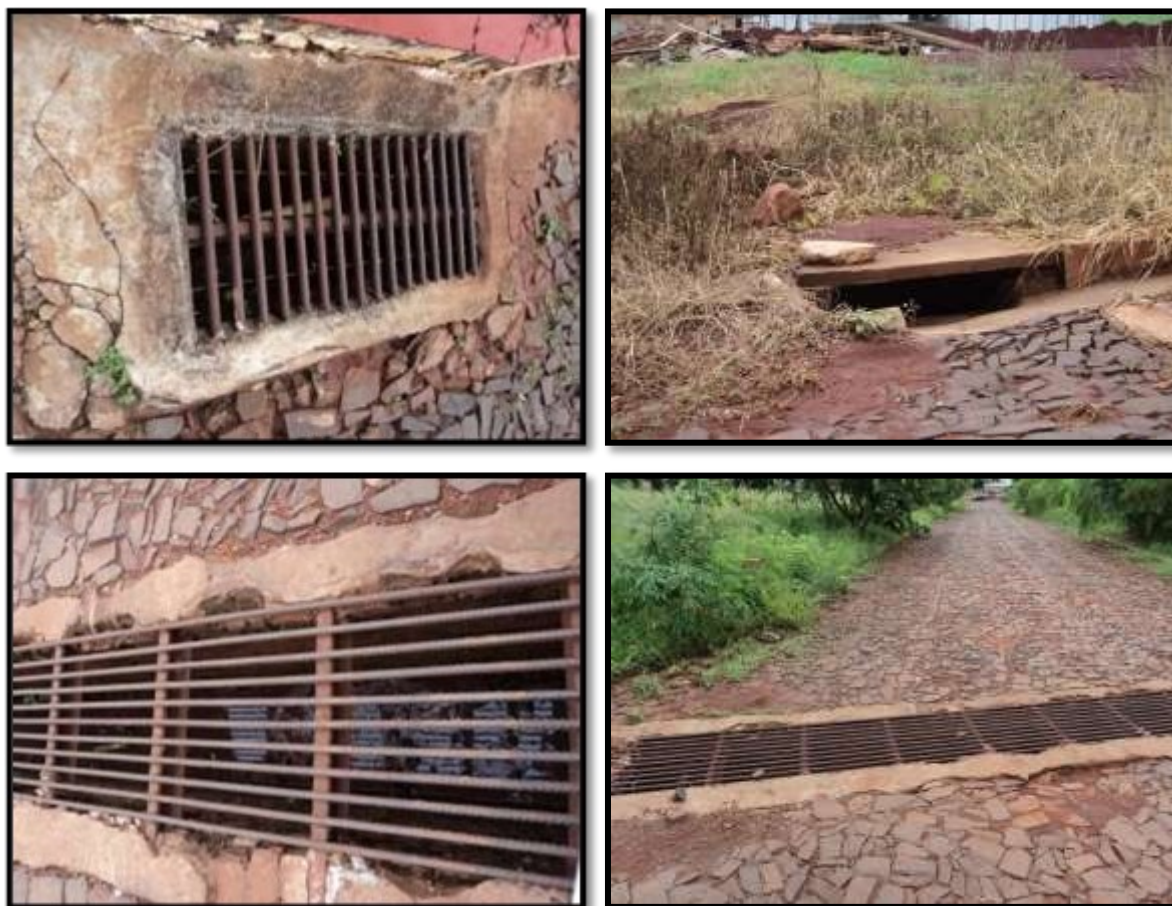
Figura 27: Estruturas de micro drenagem no município de Catuípe.
